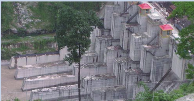
提斯塔河V型大坝建设项目，Sikkim，印度，2008。 摄影Samir Mehta，国际河流组织。
